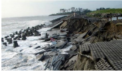
圖 1 消波塊流失後海堤基礎掏空坍塌情形
